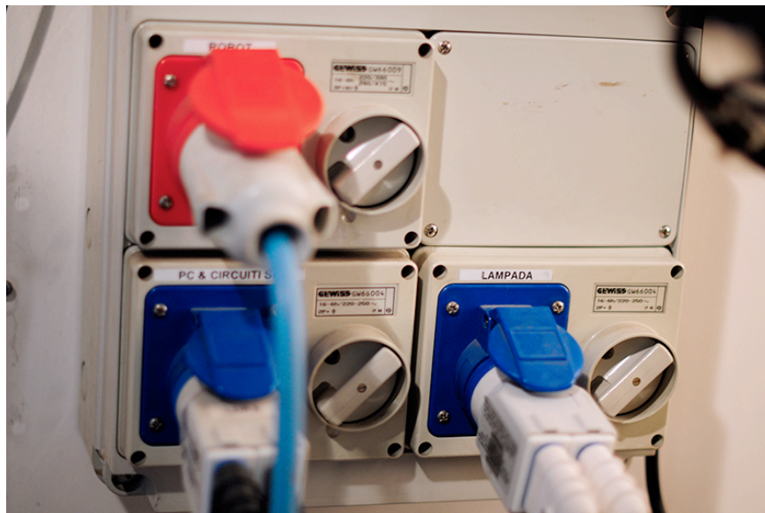
Fig. 15 - Il quadro di alimentazione
